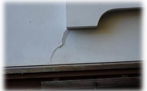
窓鳥居枠下の亀裂
