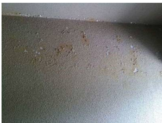
写真 9.6.5 土塁展示施設観察室内面塗膜剥離状況
