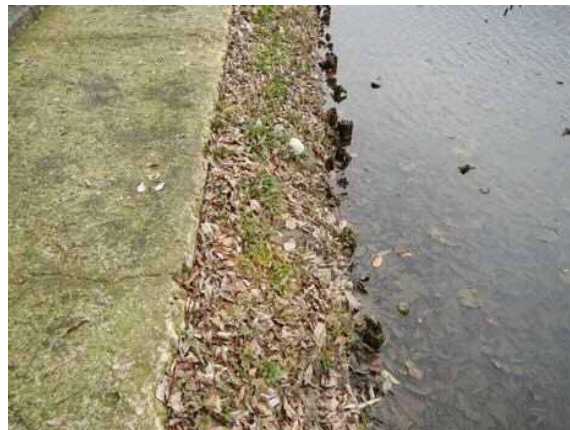
写真 9.2.2 堀の護岸状況(木柵腐食状況)
