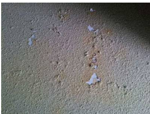
写真 9.6.6 土塁展示施設観察室内面塗膜剥離状況
