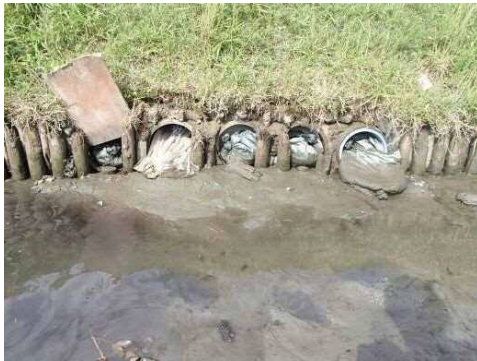
写真 9.1.1 土のうによる暗渠管の閉塞
