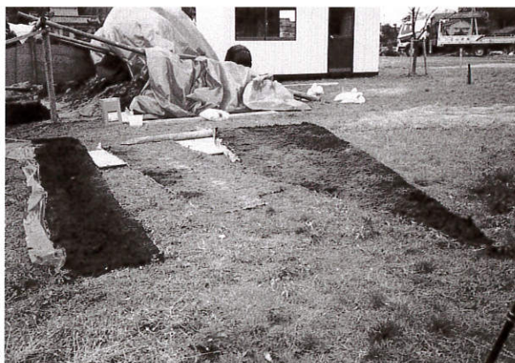
剥取りした断面
