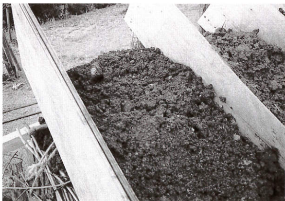
土葺き実験（クラックの状態）
