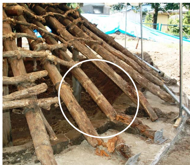
写真4 陥没箇所付近の建築材の現況 （白丸付近が陥没部分）
