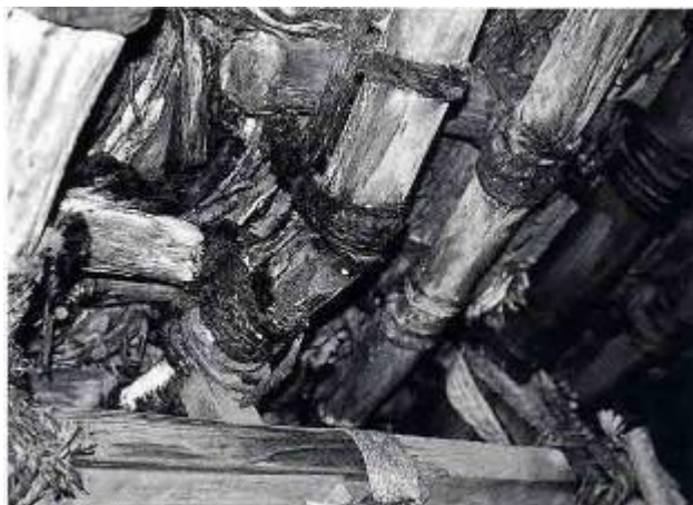
垂木が折れている状況 (13号住居)
