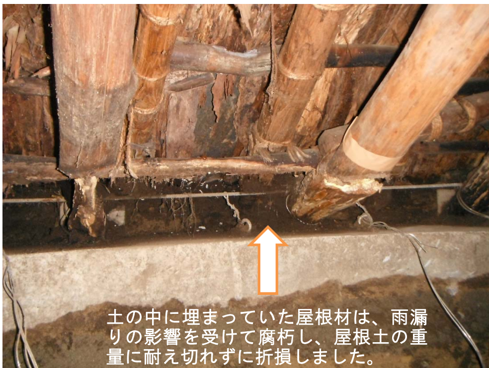
3.屋根材の折損、腐朽（28年度修理）
