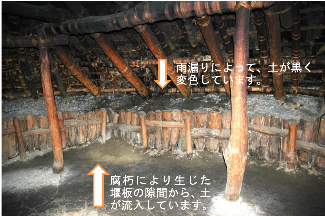
1.雨漏りと堰板の腐朽（平成24年度）
